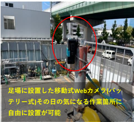
ゲート付近に設置した固定式Webカメラ(要電源) PCやアプリで画角変更やズーム等の操作が可能
