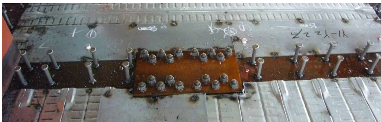
「増し打ち」していない例
