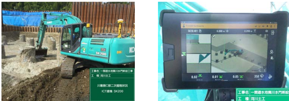
図-8 ICT 建設機械（MC バックホウ）による杭頭周囲の掘削状況
