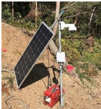
図-7 クラウド型カメラ設置状況
