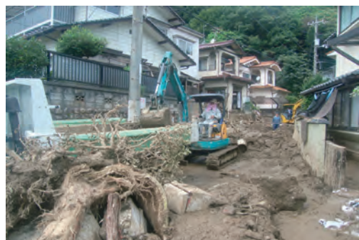
「広島土砂災害」の災害復旧活動
