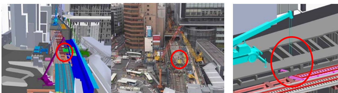
図2 クレーン2機による新設桁の合吊り架設（左：CIM、右：実際） 図3 構台上下での作業
