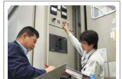
受電後の受変電設備の点検
