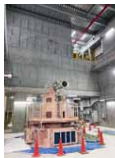
写真-3 B2F 発電機室
