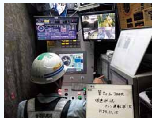
シールドマシンの運転室
