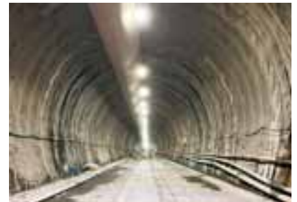
坑内 LED照明の採用
