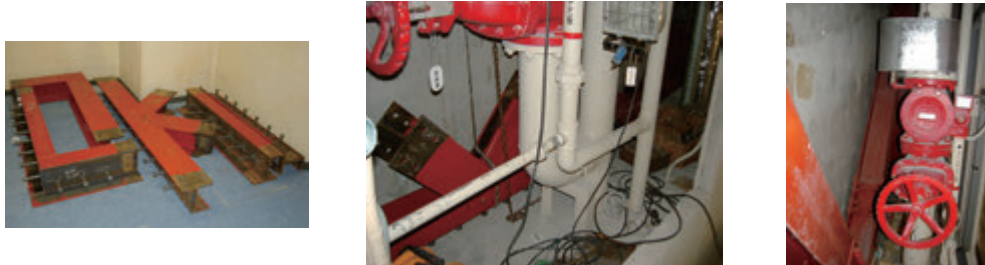
図 3-10-2 RC 壁と ALC 壁に囲まれた PS 内部に耐震ブレースを設置している例
