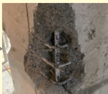
コンクリートの脆弱部が発生
