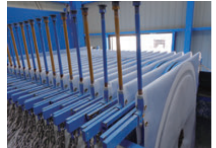
⑫ 脱水機（フィルタープレス部）
