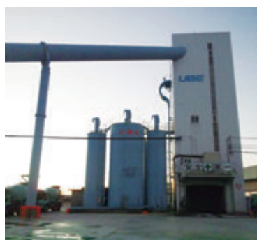
（セメントサイロ・バッチャープラント）
