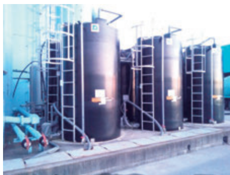
化学混和剤タンク
