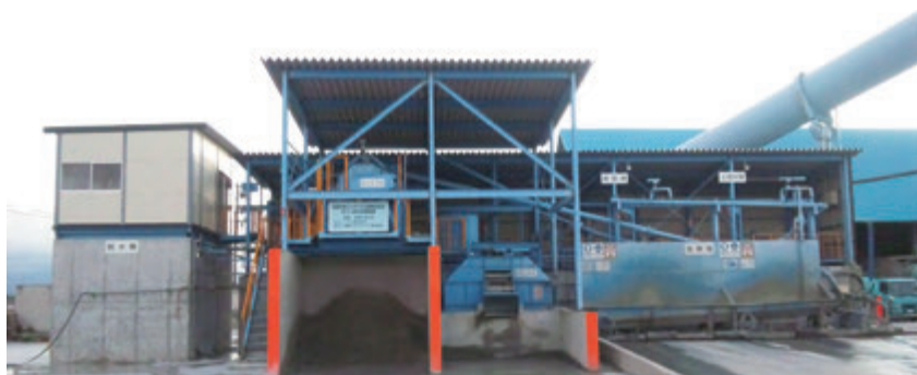
（洗車場、残コン・戻りコン処理設備）
