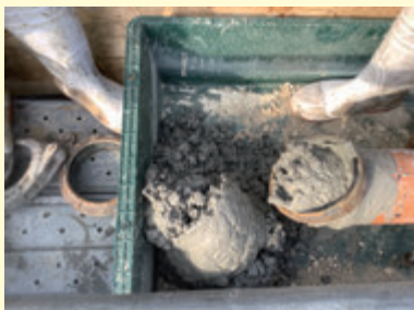
閉塞後の状況
