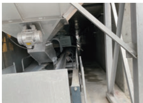
② 骨材ヤード下部（ベルトコンベア）
