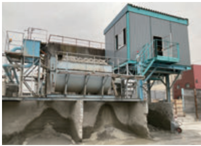
⑩ 骨材分離機 ⑫ 脱水機 外観
