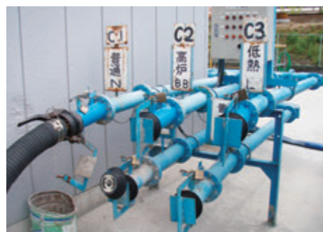
③ セメント受入れ口
