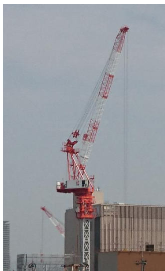
写真7 定置式クレーン
