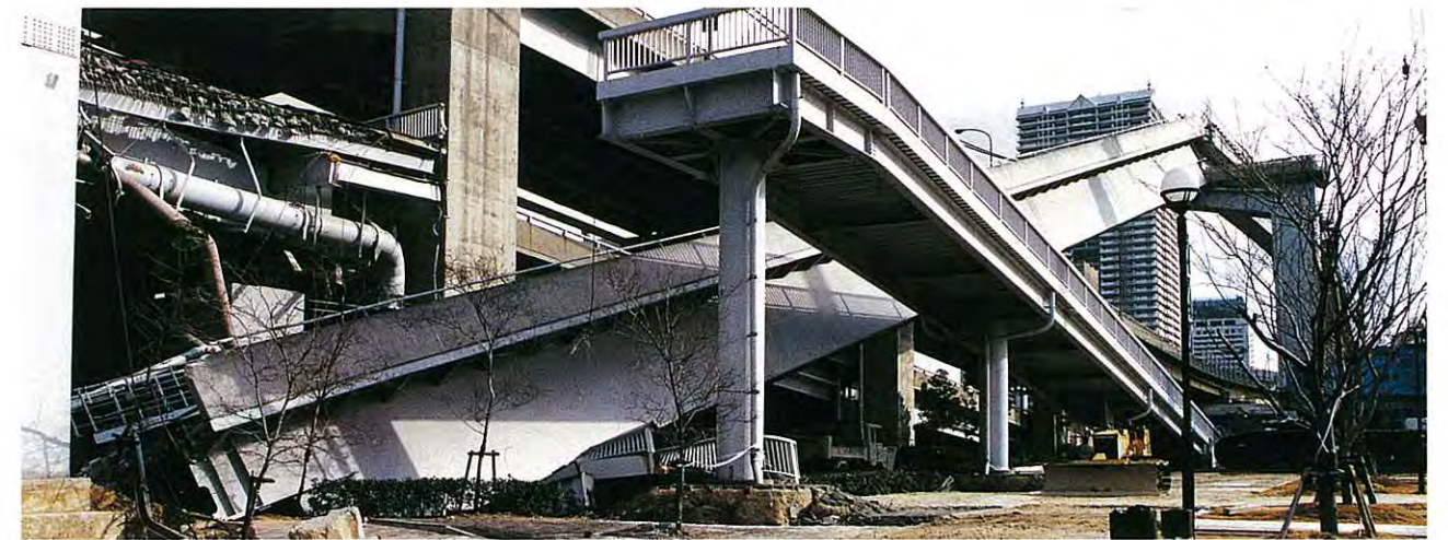
●阪神・淡路大震災被災状況
