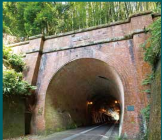
軍用引き込み線として明治時代に設けられた北吸トンネル。
