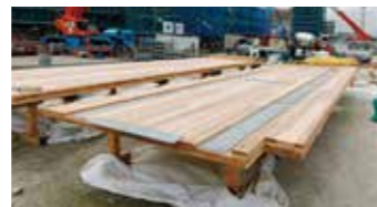
CLTパネルは最大で12mの長さがあり、専用の地組ヤードで鉄骨と組み合わせてユニット化し、クレーンで取付箇所へ運ぶ。
