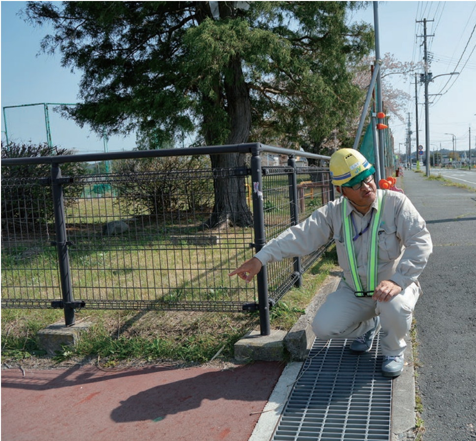
写真左側はやや傾斜しており、このままでは道路の排水などに支障をきたす。適切な接合方法を検討し、対策を講じる必要がある。
