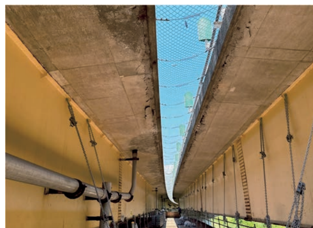
写真-1 床版の劣化状況
