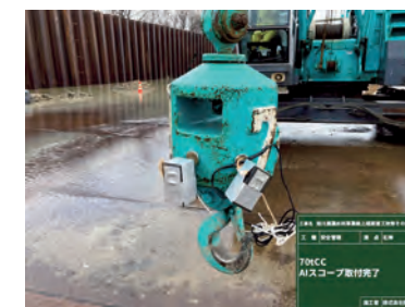
吊荷監視カメラ搭載機械
