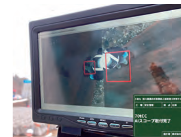
吊荷監視カメラ用モニター
