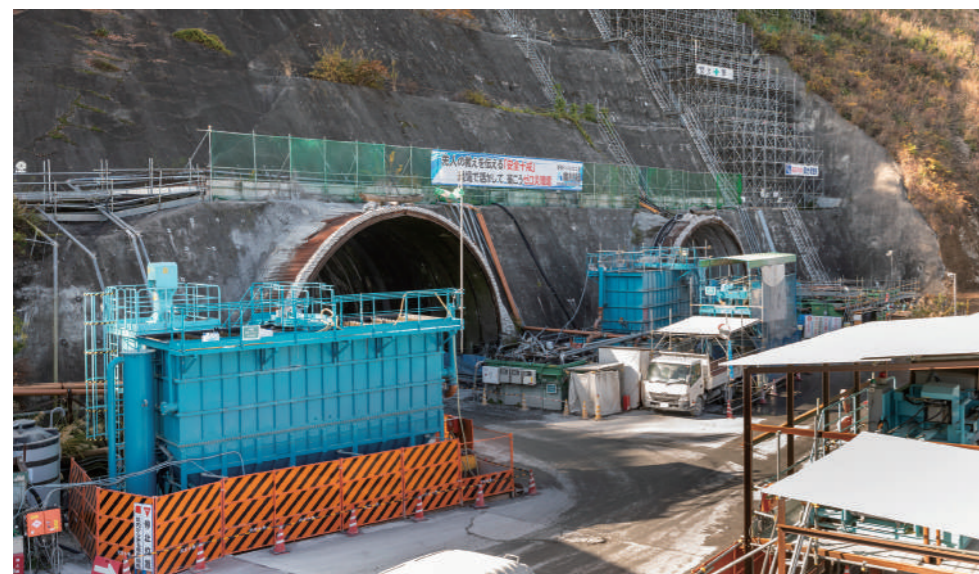
岐阜県側北工事の坑口と増強した湧水処理設備(青い設備)
