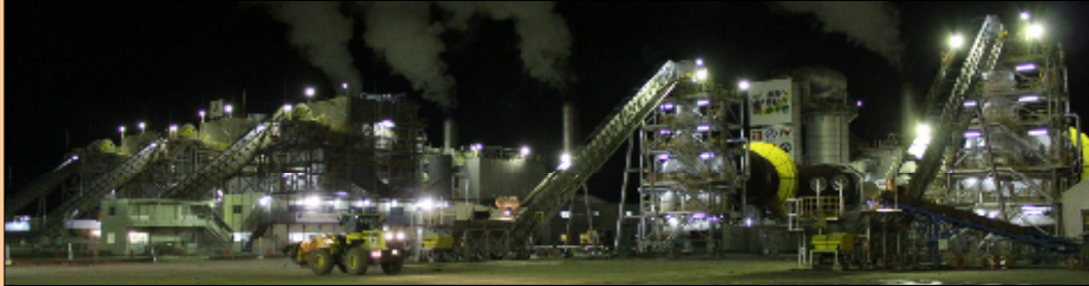
焼却炉5基の全景
