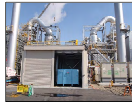
焼却炉灰出し部
