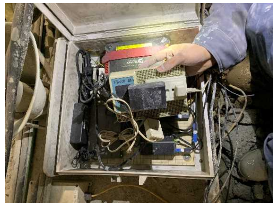
【坑内wi-fiシステム】
