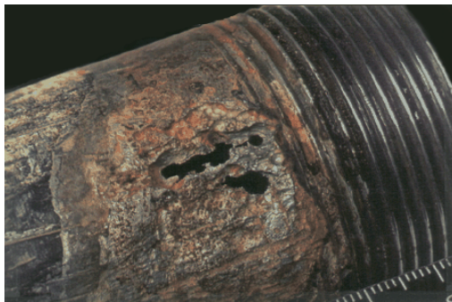
図-2 電食による配管の破損例
