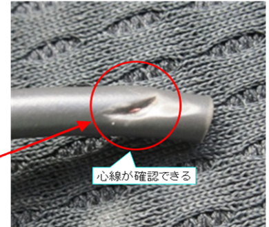
<ケーブル絶縁被覆の傷状況>
