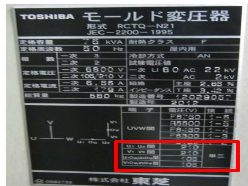
【新設トランス】
