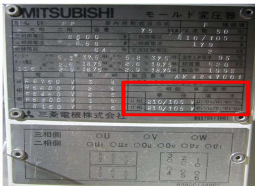
【既設トランス】
