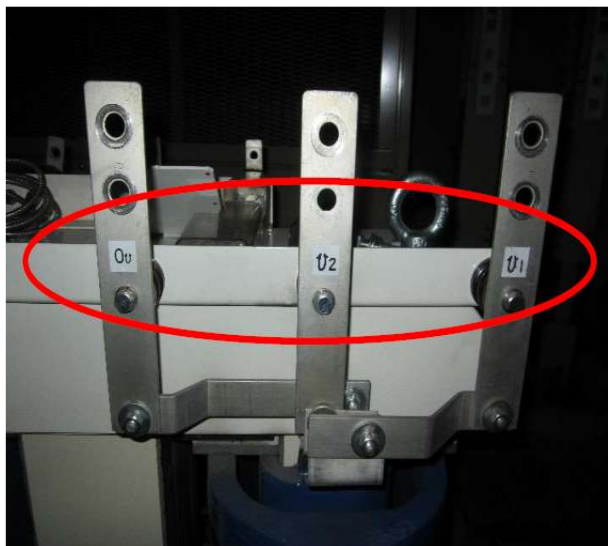
既設 二次側端子状況 (裏側から拡大撮影)
