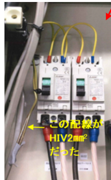
[故障時の状況]
