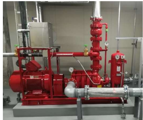
[消火ポンプユニット]
