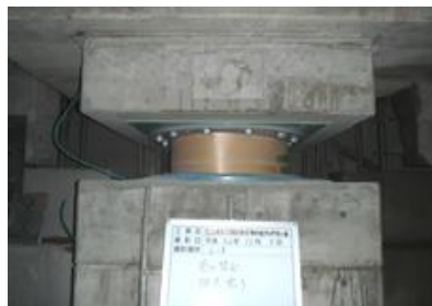
免震装置設置柱
