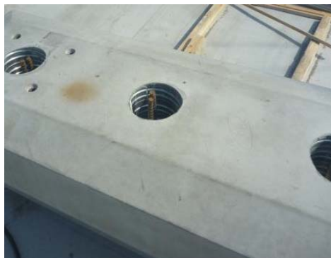
屋上機械基礎PCaの定着部の状況
