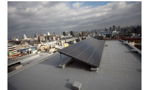
ソーラーシステム（住棟屋上）
