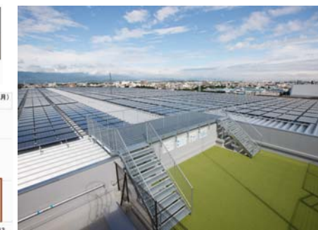
太陽光パネルと見学スペース
