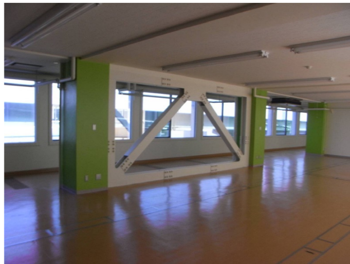
本社棟食堂の耐震ブレース
