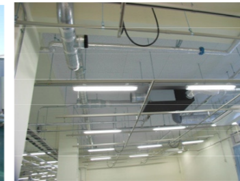
西工場の全熱交換形換気ユニット
