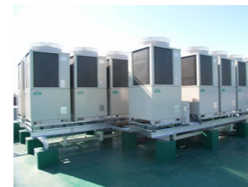
西工場のヒートポンプ室外機
