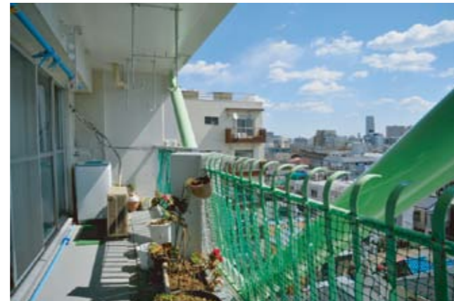
制震ブレース取付状況(バルコニー内部) 写真 制震ブレース取付状況
