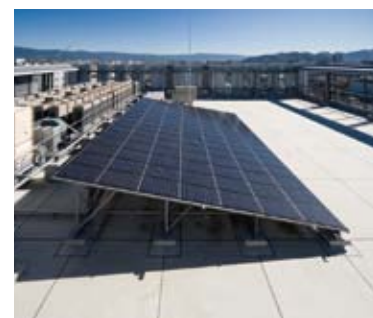
太陽光発電パネル(屋上)
