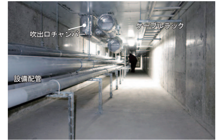
配管ピットを兼用したクール・ホットチューブ
