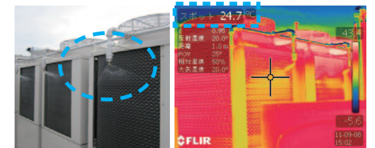
散水中の室外機 サーモカメラによる検証
