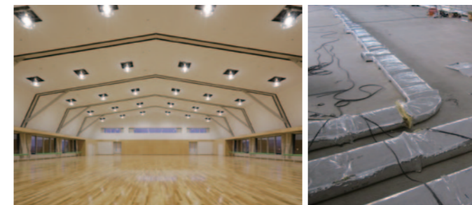
アリーナ 床下ダクト
