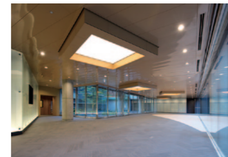
1Fエントランスホール（輻射冷暖房システム）
