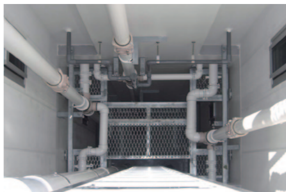
採光・通風と将来の配管更新スペースを確保したMS
