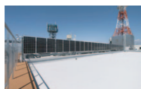
屋上太陽光発電パネル
