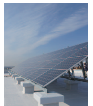
太陽光発電設備パネル
