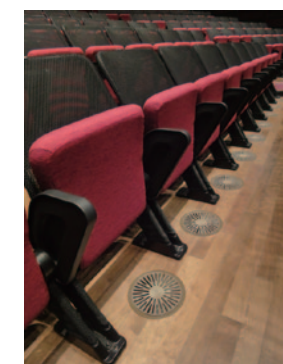
床吹き出し空調
