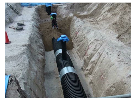
クール&ヒートトレンチ
