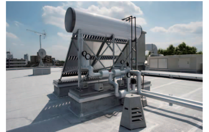
真空式太陽熱集熱パネル②
