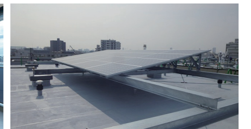
太陽光パネル
