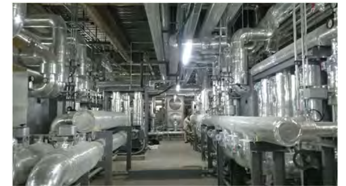
地域冷暖房の受け入れ（熱交換機械室）
