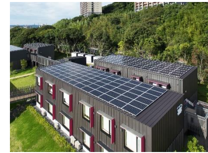
太陽光パネル
