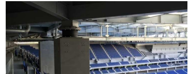
約3,500トンの屋根を支える高減衰系積層ゴム
