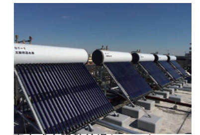
真空式太陽熱給湯システム
