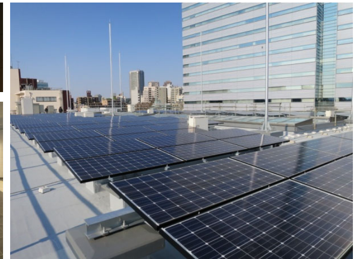
屋上の太陽電池モジュール
