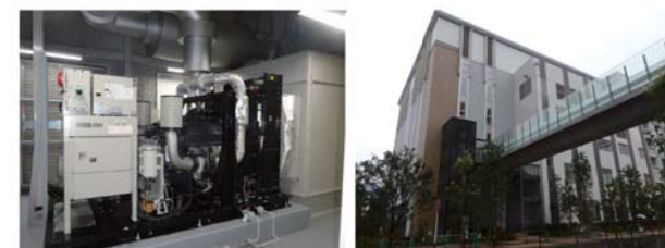
非常用発電機
