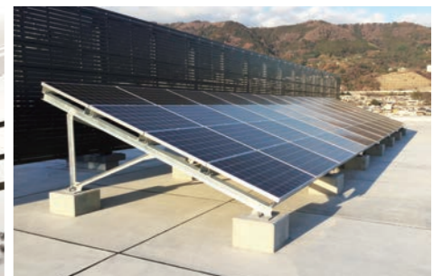
写真-3. 太陽光発電装置
