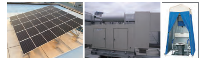
太陽光発電 防災設備(非常用発電・マンホールトイレ)
